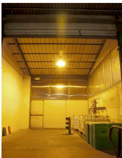
Capannone illuminato con lampade a scarica. Le ombre sono più accentuate
